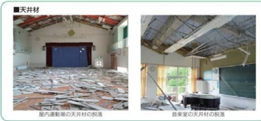
写真1 学校の天井落下被害（文部科学省，2015）
