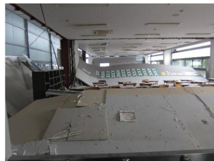
教室間の間仕切り壁の転倒
