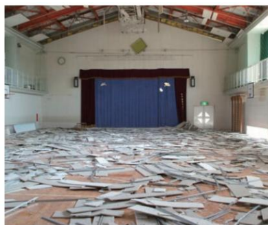
屋内運動場の天井材の脱落
