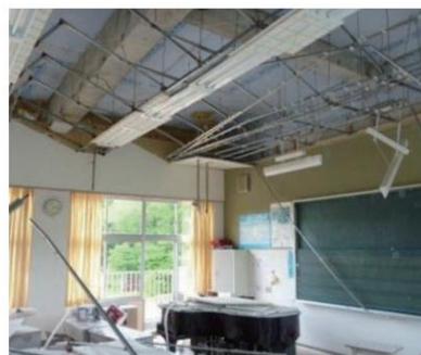
音楽室の天井材の脱落
