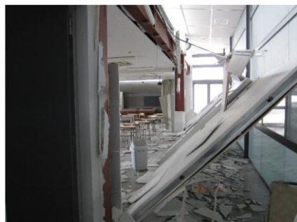
廊下の間仕切り壁の転倒
