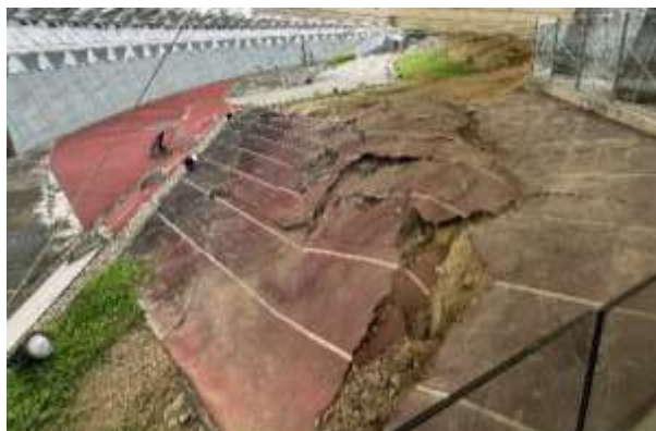
小学校校庭に現れた断層のずれ
