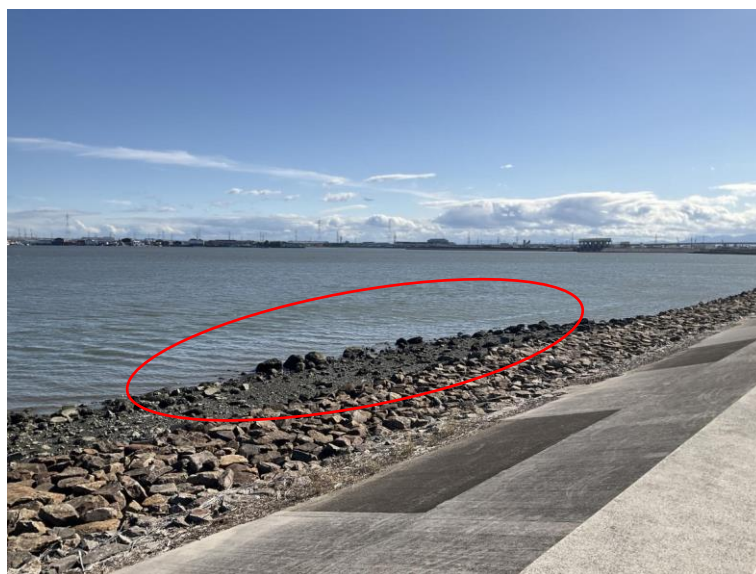
図 8：破堤した当時の堤防の残土（筆者撮影）
