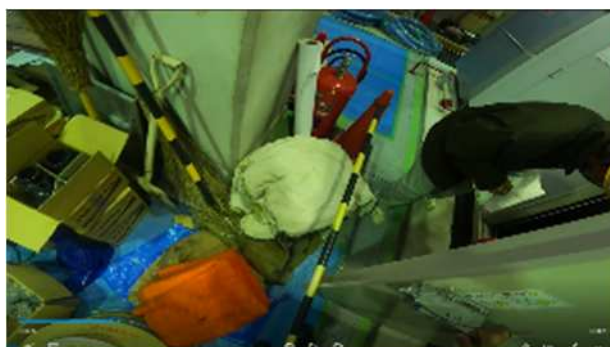
図8 映像資料（自家発電設備の点検）：工事用資材が仮置きしてあり、点検扉の開閉に苦慮している様子が記録されている。
