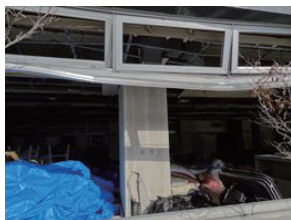
写真1 被災した雄勝総合支所
