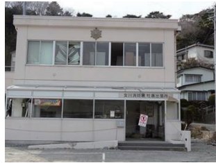
写真8 津波により被災した女川消防署牡鹿出張所
