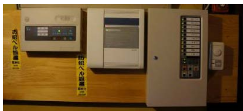
図7 愛知県R寺の防犯警報監視盤(盗難後)
