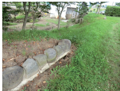
写真-3 水路からの溢水跡
