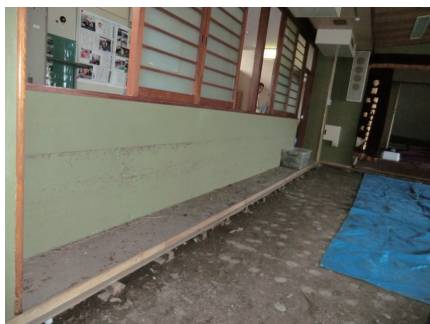
写真-4 被災した養護老人ホーム
