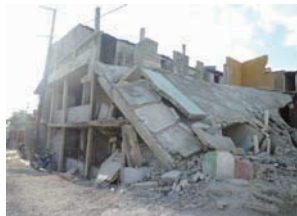
低地における建物被害
