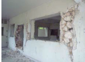
建物内部の被害の詳細
