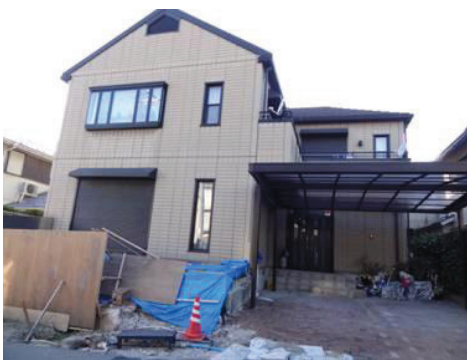
写真 3 震災から約 3 ヶ月後に傾斜が増大した住宅(浦安市美浜)
