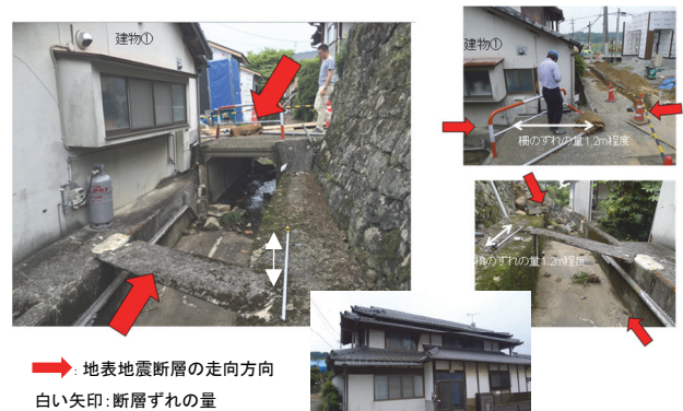
図2 下陳の三竹における地表断層と建物の状況
