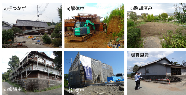
写真 1 住宅再建状況の目視判定イメージ(筆者撮影)
